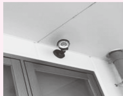
▲こども園に設置している防犯カメラ
